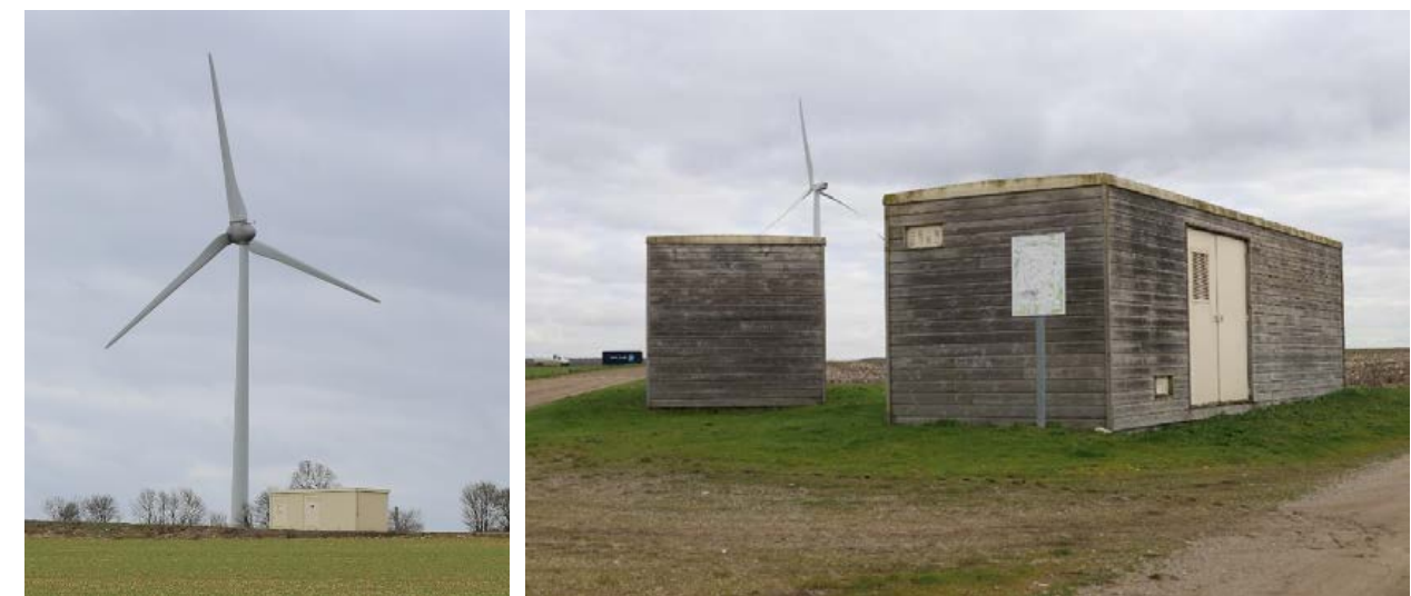
Figure 6 : Exemples de poste de livraison électrique (Source : AEPE-Gingko)
